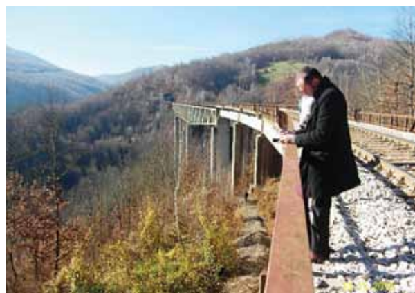
Antikorozijski premazni sistemi so na obstoječih mostovih stari tudi že 20 in več let ter jih je že načel zob časa.
